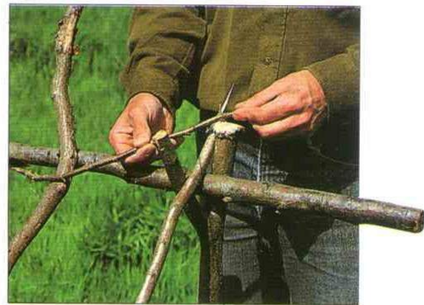
Entreteja las ramas inclinadas con el travesaño para dar mayor estabilidad a la estructura y evitar que las ramas se muevan
